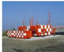
非常用レーダー設備
